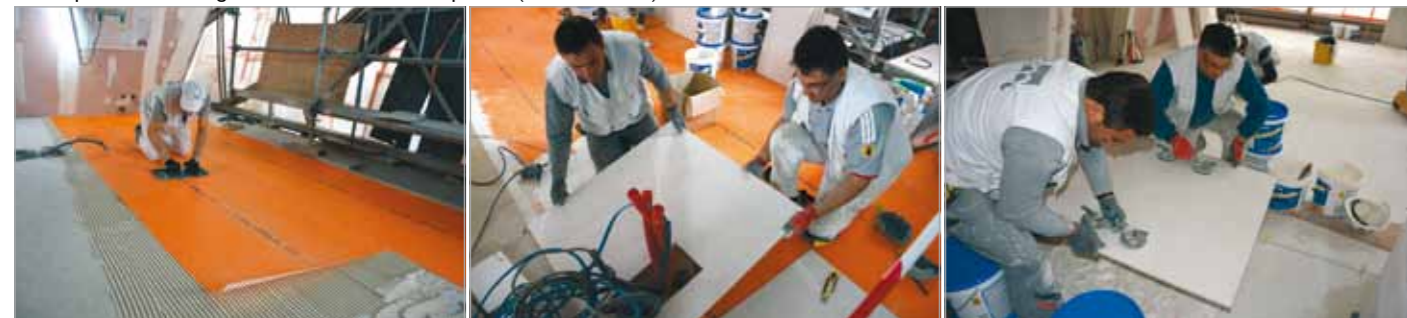
Diese Bilder zeigen einige Schritte der Bodenrenovierung: das Verkleben der Verbundentkoppelung, das Einpassen und Verlegen der Natursteinverbundplatten (Fotos: Schlüter).
