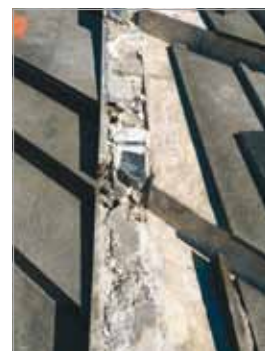
Keinesfalls staatsmännisch repräsentativ: Die Schäden an den Treppenstufen waren nicht nur unschön, sondern auch ein Sicherheitsrisiko.
