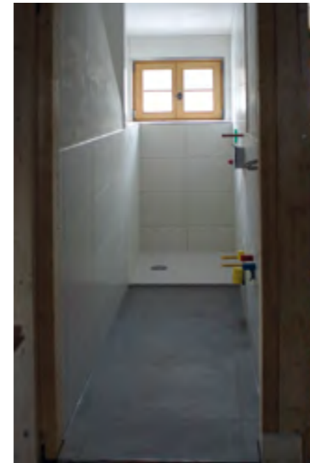
Einfach, aber sauber und attraktiv präsentieren sich nach der Sanierung die Duschen und WC-Räume.
